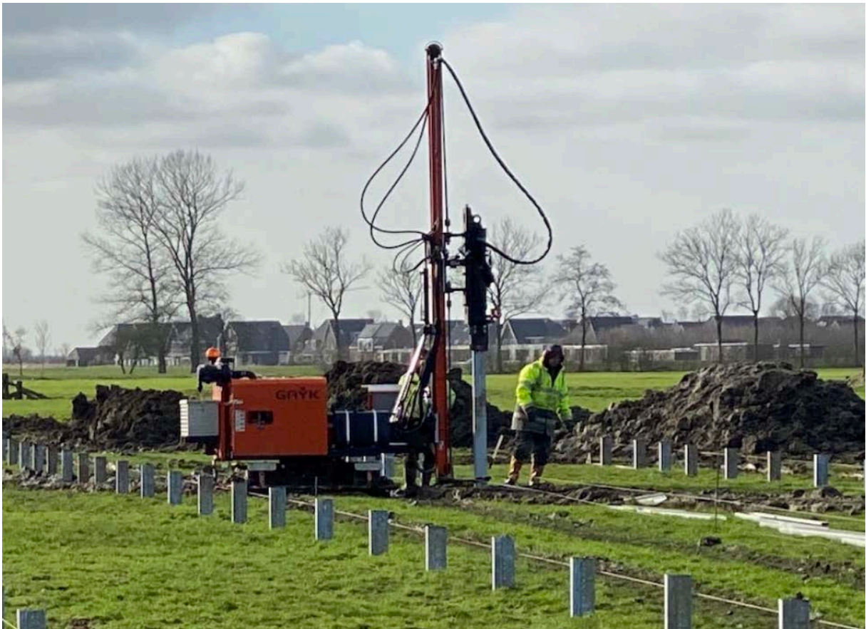
Figur 10 Eksempel på pælemaskin for fundamenter fra konstruksjonen av Energeias solkraftverk i Nederland.
